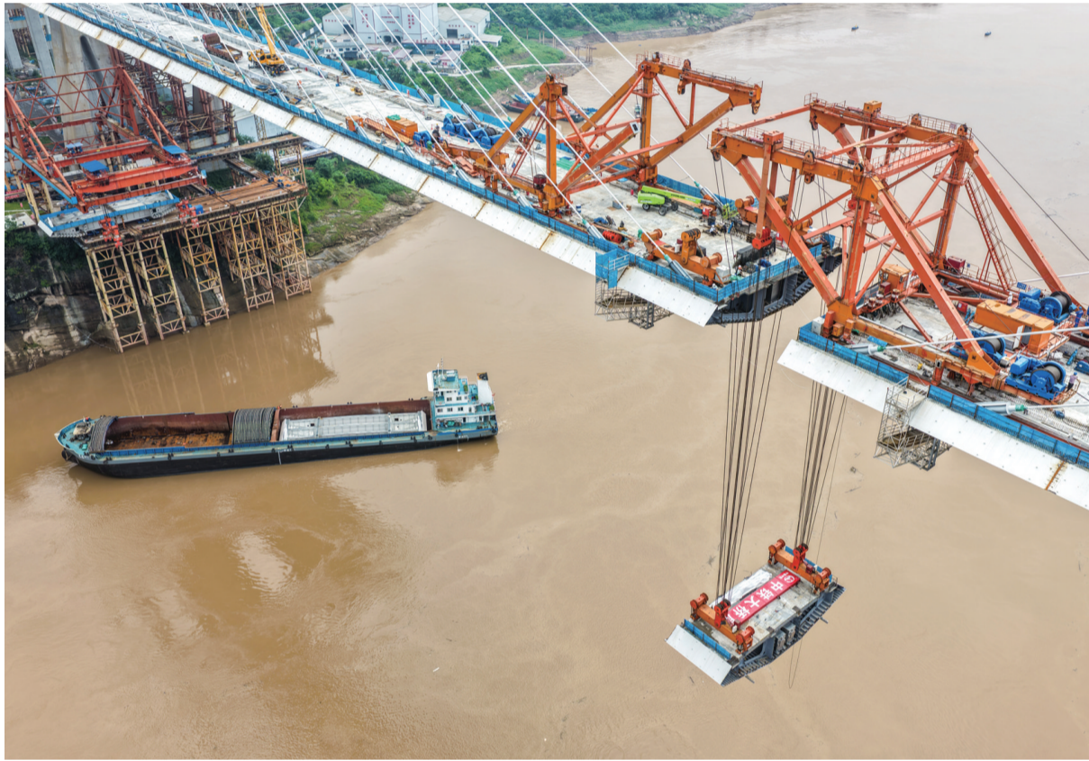
5月26日，渝万高铁石沱长江大桥建设现场，施工人员在吊装最后一段钢混组合梁(无人机照片)。 5月27日，新建重庆至万州高速铁路(简称：渝万高铁)全线控制性工程石沱长江大桥合龙，标志着渝万高铁全线149座桥梁全部合龙，为全线按期通车奠定了坚实基础。 石沱长江大桥位于重庆市涪陵区，由中铁大桥勘测设计研究院、中铁二院设计，中铁大桥局承建，大桥全长1416.9米，其中主桥长1056米。大桥创新采用公铁合建双塔塔架结构，铁路部分桥梁于5月27日合龙，公路部分桥梁将于今年年底前合龙。 渝万高铁是我国“八纵八横”高速铁路主通道京昆、包海通道的重要组成部分，线路正线全长251公里，设计时速350公里。 新华社记者 唐奕 摄
