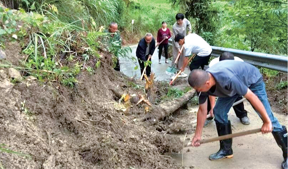
滑坡未造成人员伤亡。次日雨势减弱后，党员干部与志愿者再度赶赴现场，清理塌方泥土、倒伏林木，疏通排水沟渠，彻底消除安全隐患。截至5月19日，全乡稳妥转移安置群众24户88人，实现应转尽转、不落一户、不漏一人。
