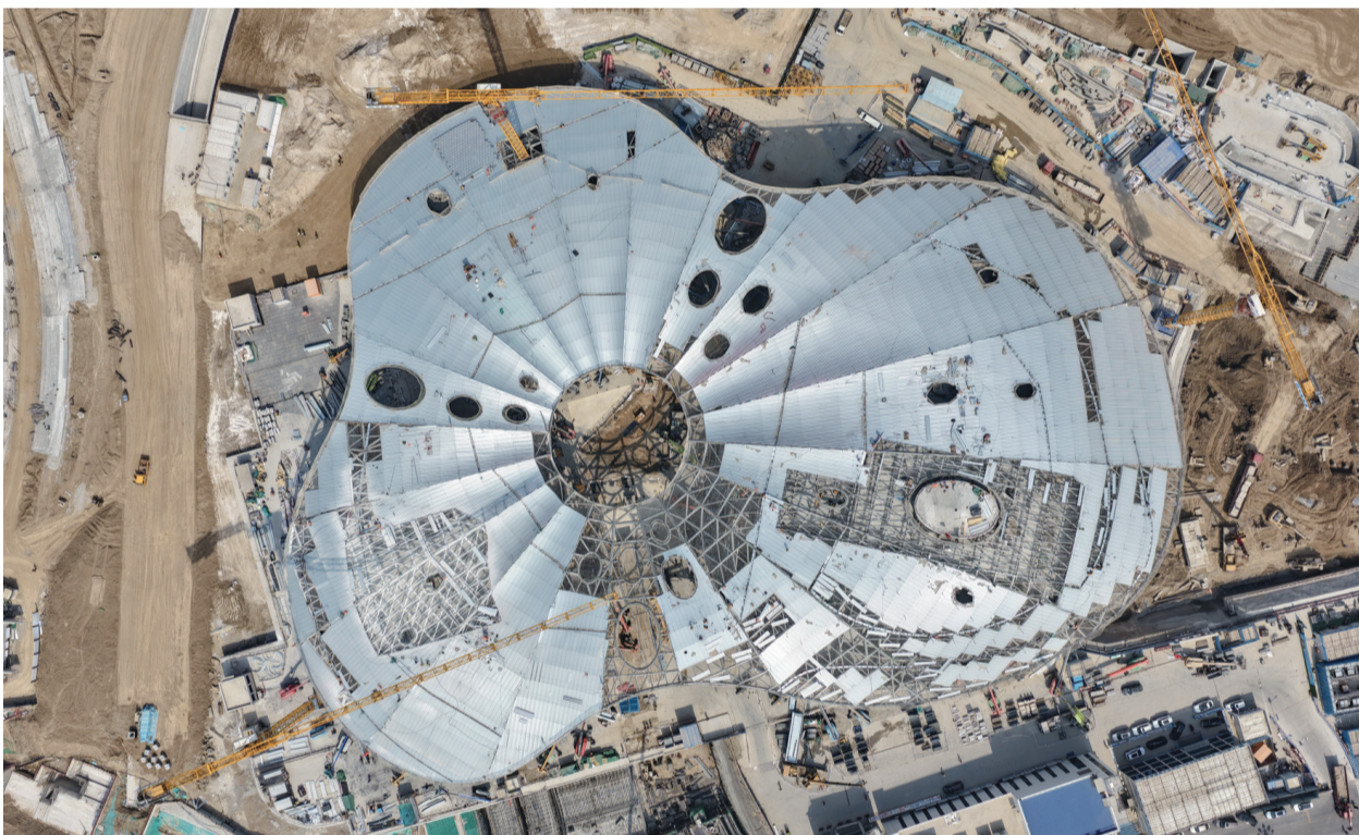
雄安新区启动区城市文化广场项目建设现场（4月2日摄，无人机照片）。
