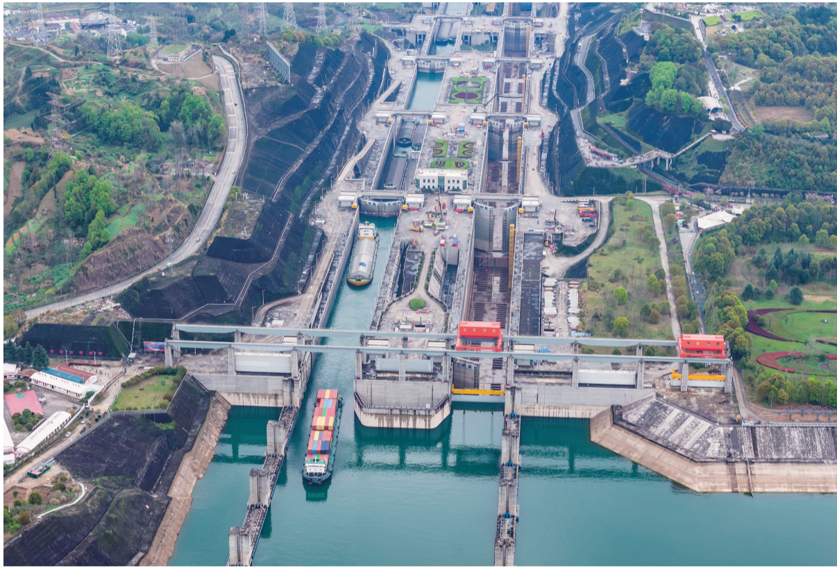
3月30日，湖北宜昌，三峡枢纽南线船闸正加紧检修，北线船闸有序通航（无人机照片）。三峡南线船闸2026年计划性停航检修于3月4日开工，计划工期45天，目前施工进度过半。检修期间，三峡枢纽通航保障有力，各类重点急运物资有序过坝。 新华社发（郑家裕 摄）
