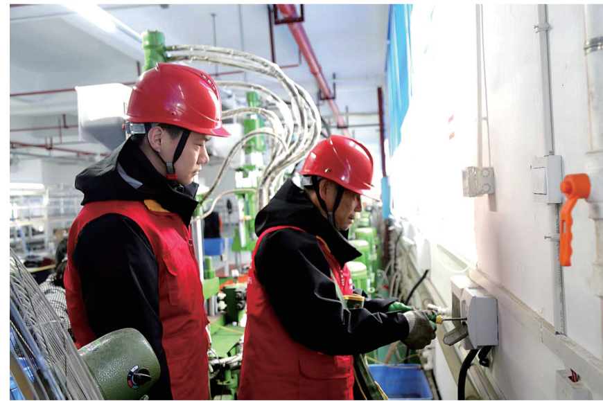
3月1日，国网慈利县供电公司“共产党员服务队”来到湖南大发电子科技有限公司生产车间，对变压器、开关柜、线路接头等核心设备进行“体检”。
