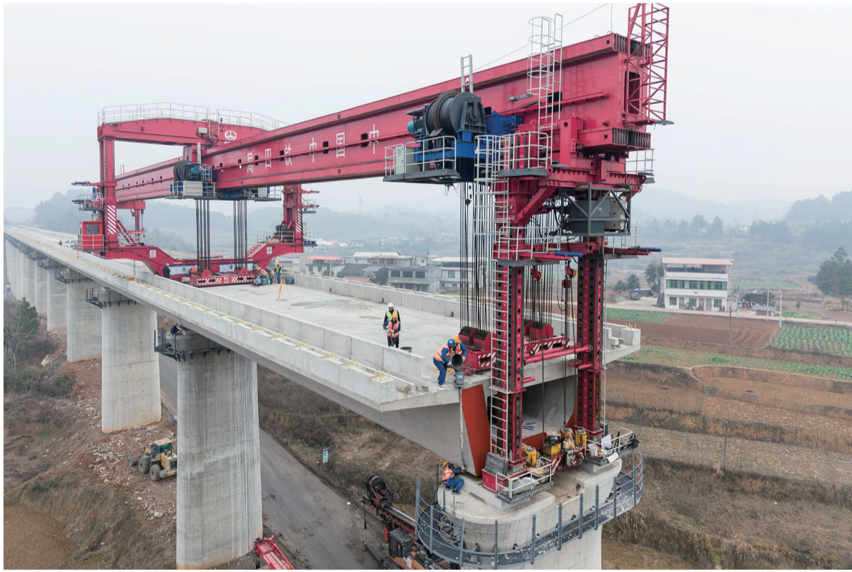
2月5日，在邵永高铁肖吉普特大桥建设工地，中铁四局工人正在进行箱梁架设作业（无人照照片）。春节临近，在湖南邵（阳）永（州）高铁建设工地，施工人员抢抓工期，确保重点工程建设进度有序推进。
