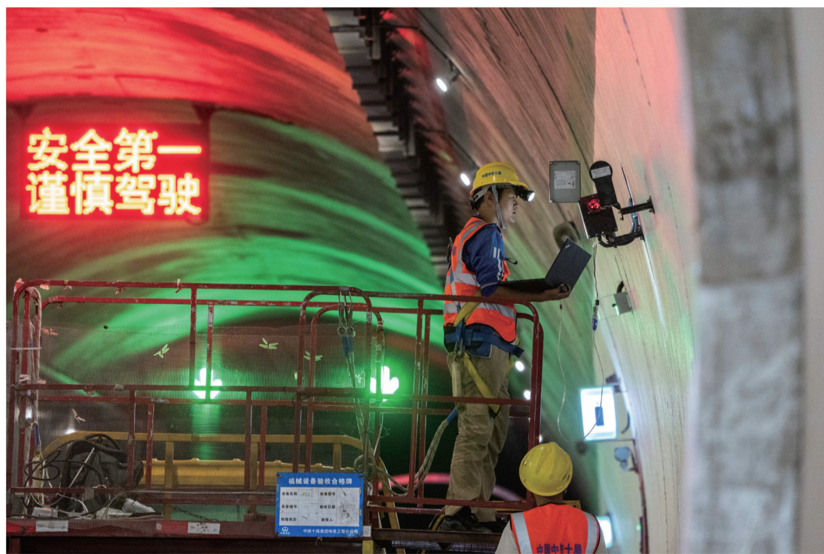
8月19日，在湖南炉慈高速太平镇隧道，中铁十局技术人员调试隧道环境监测设备。
