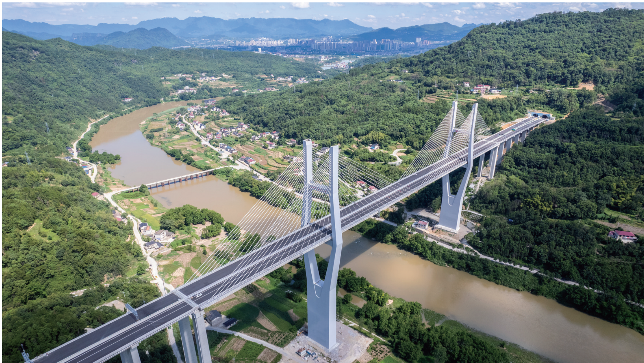
这是8月19日在湖南炉慈高速公路建设施工现场拍摄的长潭河凉水大桥（无人机照片）。
