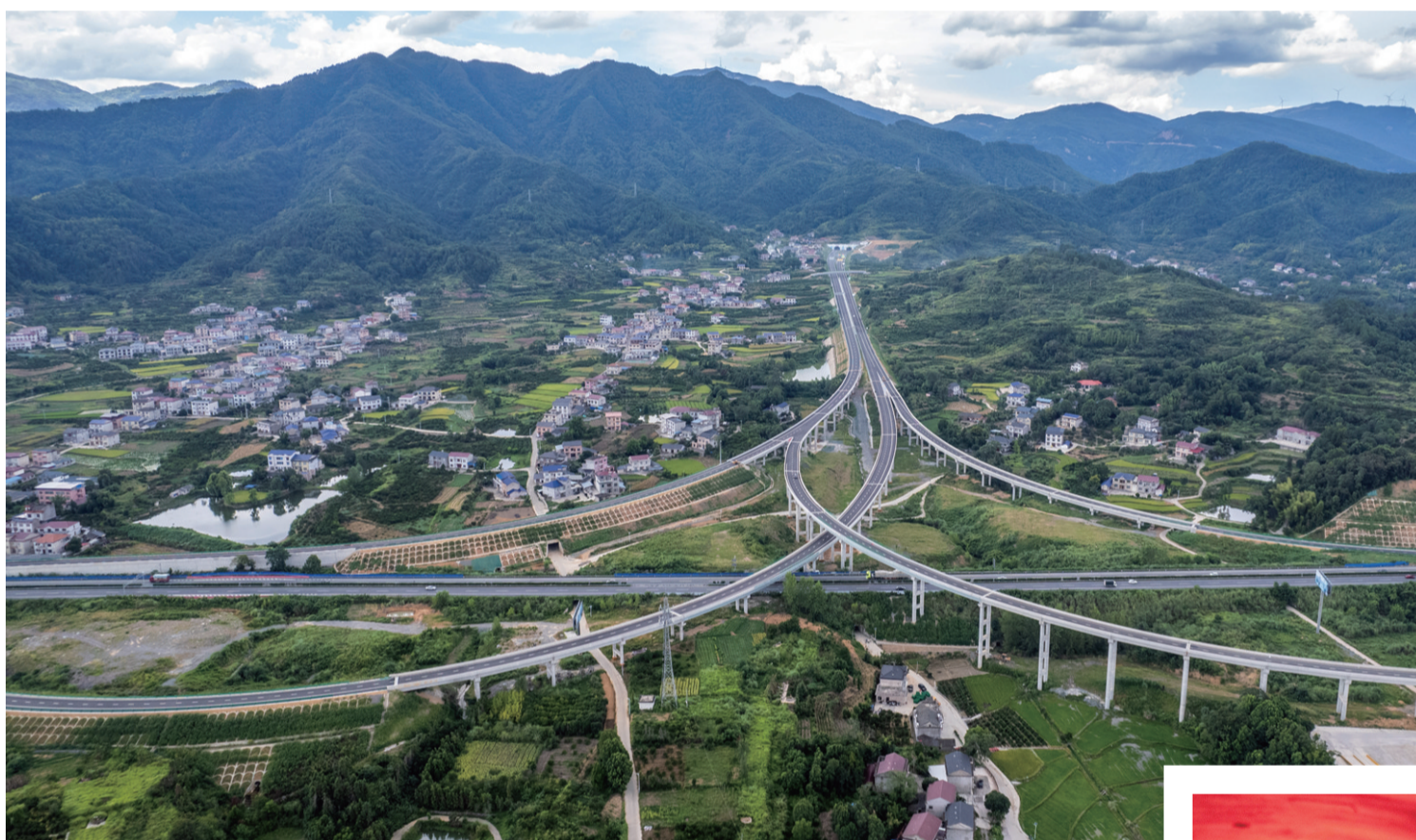
▲这是8月19日在湖南炉慈高速公路建设施工现场拍摄的慈利西互通枢纽（无人机照片）。
