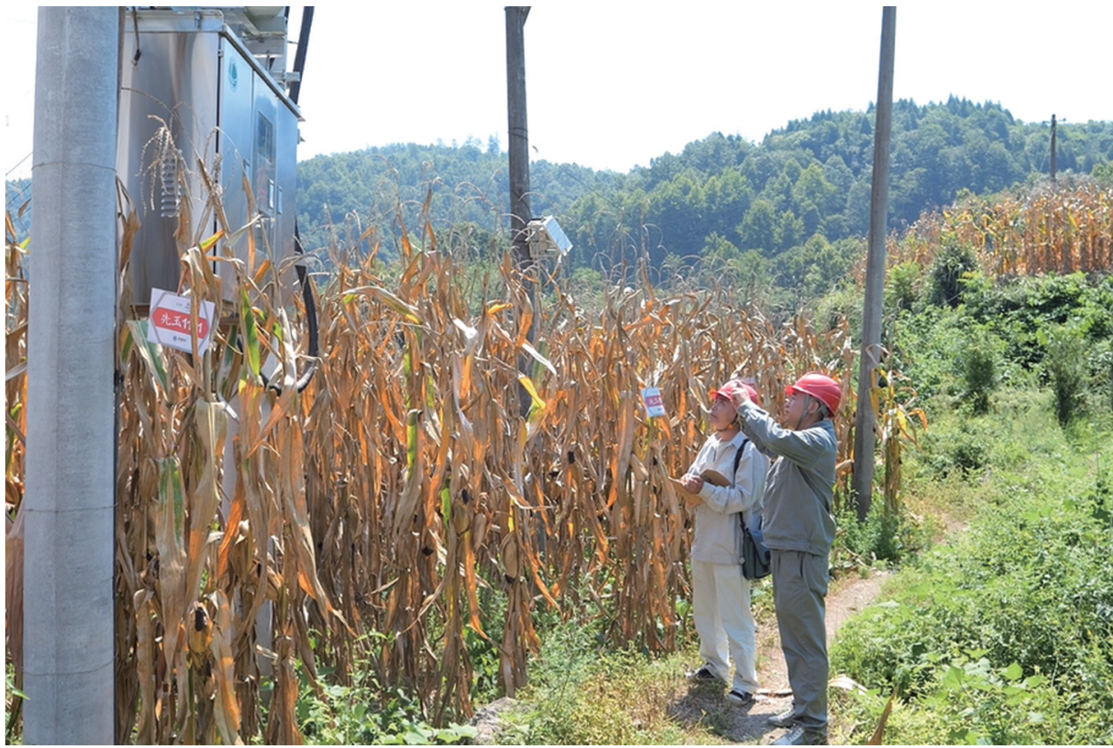
8月15日，国网桑植县供电公司洪家关供电所工作人员走进桥弯镇长坪村的烟叶烘烤基地，详细了解烤烟用电情况，对烤烟用电设备进行全面的“义诊”。为确保烟农在烤烟期间的正常用电，连日来，国网桑植县供电公司涉及电烤烟的乡镇变电站和高低压线路设备进行拉网式排查，建立隐患销缺台账，并及时进行了整改。郭军 辛叶 摄
