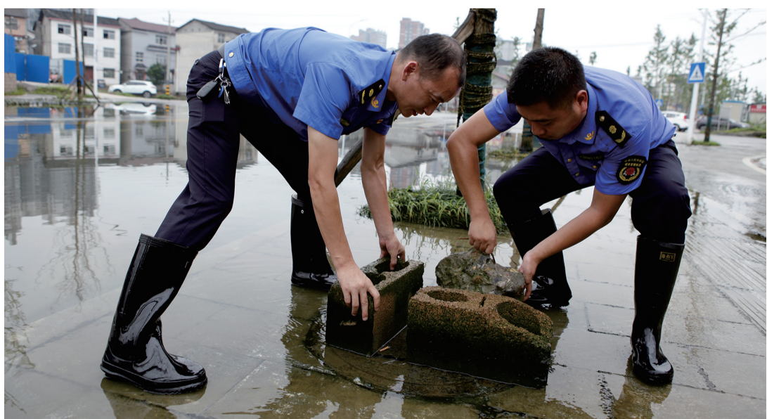
6月12日 区城管局十二中队接到局领导指令,永定区西溪坪办事处三清市场后门永安东路三岔口由于下水道堵塞致使污水从下水道溢出造成永安路大面积积水,十二中队迅速赶到现场,对溢出污水的下水道井盖进行处置,并在积水路边设置警示!
