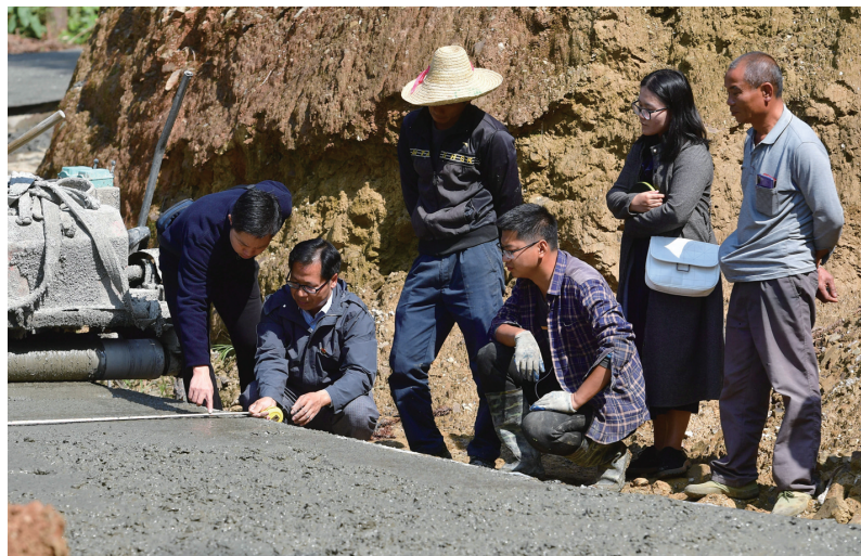
11月5日，在广西柳州市融水苗族自治县良寨乡培洞村，纪检监察干部(左二)在检查扶贫道路施工情况。
