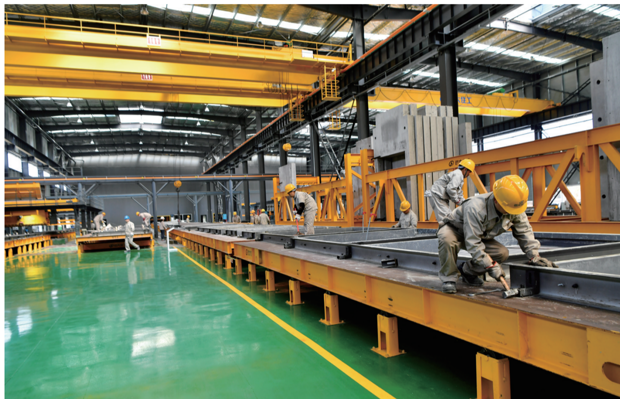
张家界远大住工探索建筑工业化，在充分吸纳美国、日本、德国、新加坡等国家先进理念的基础上，远大住工建立了自主建筑工业化研发、制造、施工、材料体系，技术专利超过300项，PC生产制造和BIM设计建造技术领先世界，建筑工业化率达85%以上，真正实现质量、进度、成本的三大可控。图为张家界远大住宅工业有限公司工人正在跟进设计图纸进行PC构件模具的清理、安装。
