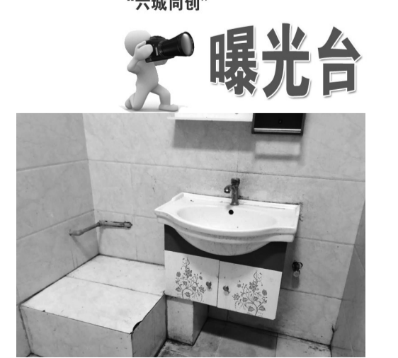
武陵源区政府对面商贸城内公厕水龙头无水，卫生状况差。(本栏目图片均由社会监督员提供)
