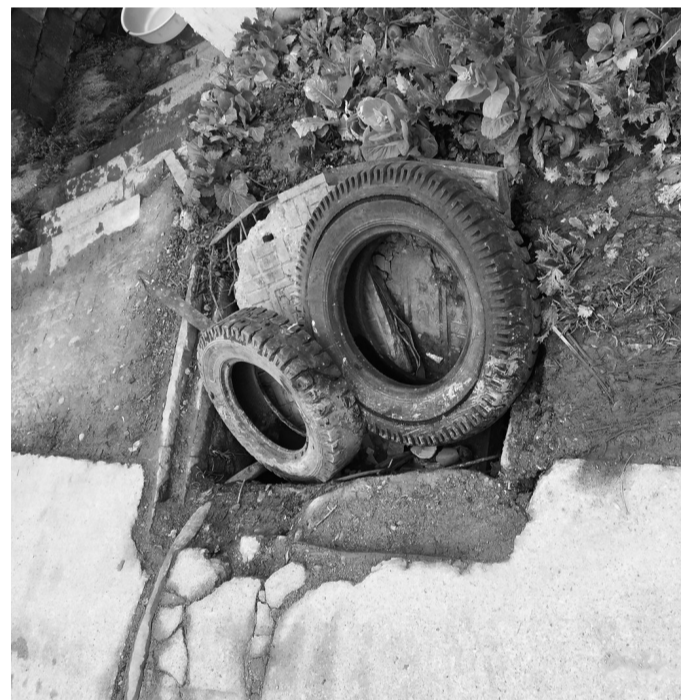
永定区龙门社区靠火车站铁路旁一处井盖损坏。
