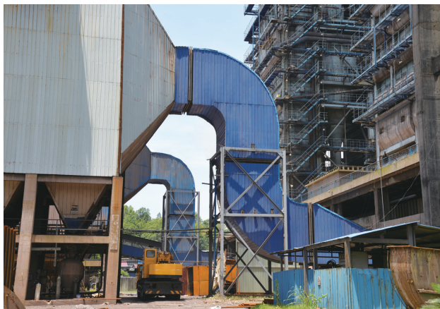
桑梓火电厂脱硫除尘装置
